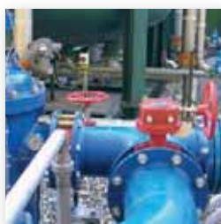
■ Traitement de l'eau
